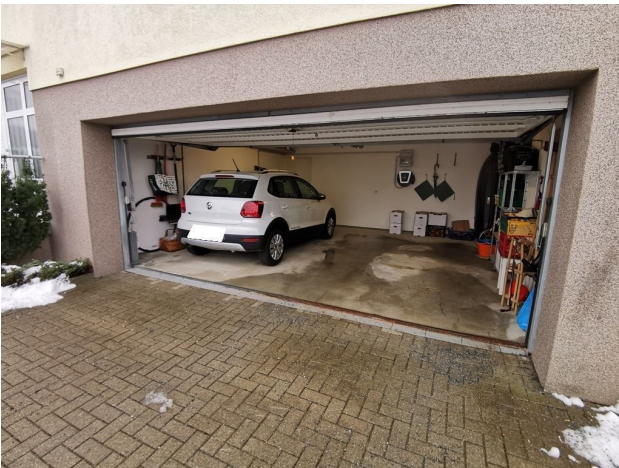
Garagenstellplatz mit Wallbox
